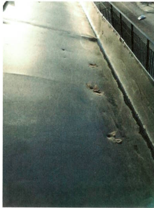
12. Västra gaveln. Gamla hål. Dock är dom helt okej lödda och lagade.
