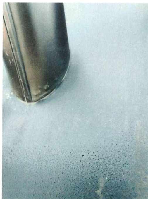
8. Avloppsluftningarna saknar fog. Dock så kan dom mycket väl vara fogade invändigt istället.
